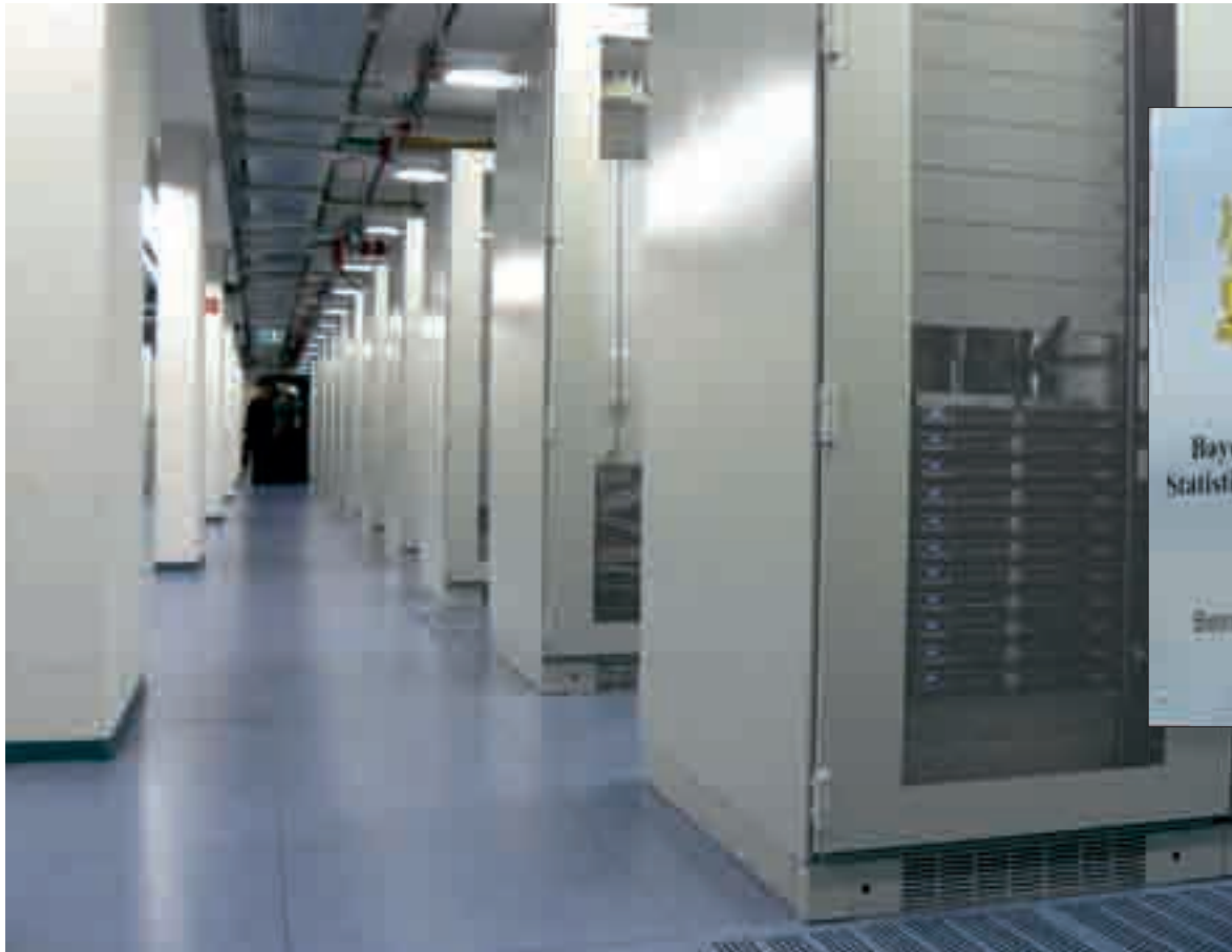
Moderne „Server-Landschaft“ in der Betriebsstätte Maillinger- straße 11 in München.
